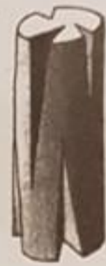
ستون ترک خورده chapped column
