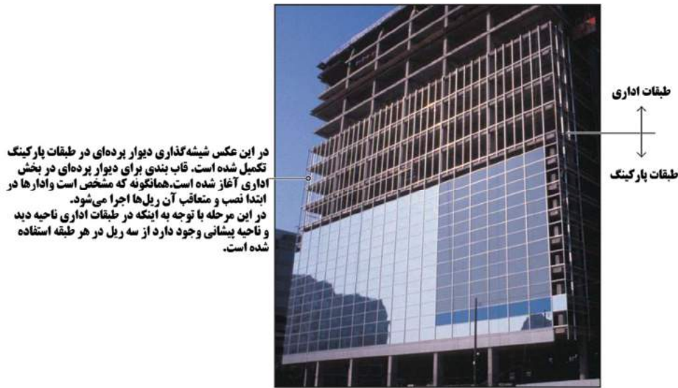
شکل ۸-۷- مراحل نصب دیوار برده‌ای شیشه-آلومینیوم درجا در یک ساختمان اداری که در آن طبقات زیرین پارکینگ و طبقات بالایی اداری است.
